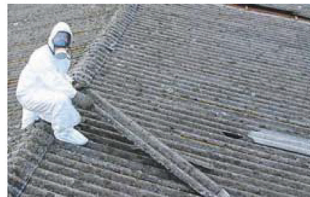
Amianto, bonifica complessa. A Mirabello la discarica?
